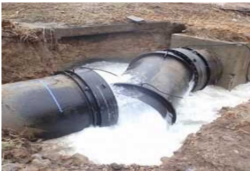
水道管の継手の破損（他市）
