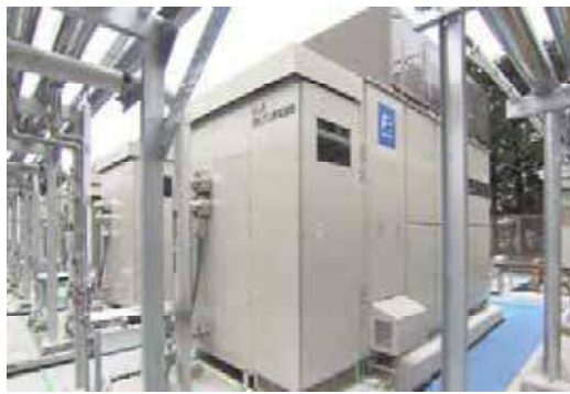
下水汚泥消化ガス *14 発電施設（川田水再生センター）
