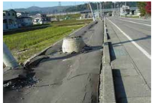
マンホールの浮上（他市）
