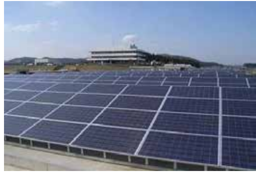
松田新田浄水場における太陽光発電設備
