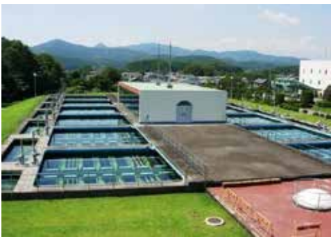
松田新田浄水場
