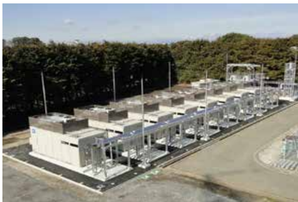
川田水再生センター消化ガス発電施設
