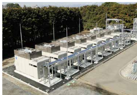
川田水再生センター消化ガス発電施設
