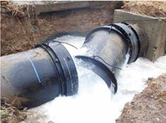
水道管の継手の破損（他市）
