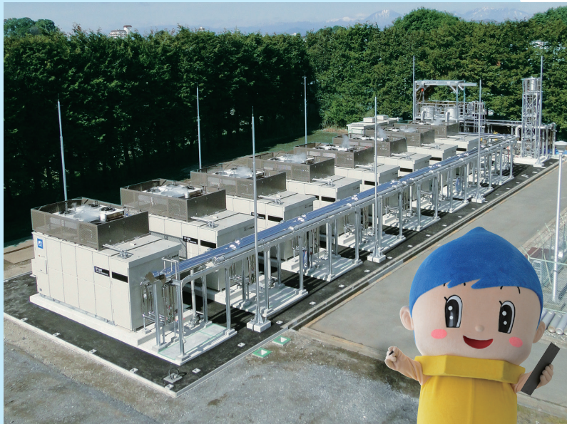
汚泥消化ガス発電施設(川田水再生センター)
