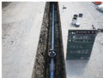
新しい水道管
