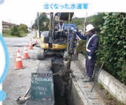
古くなった水道管
