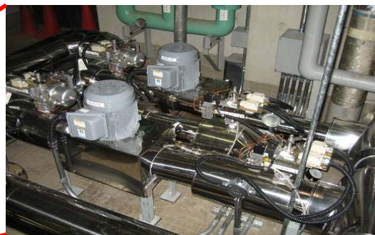
【設置されている発電機と水車】
