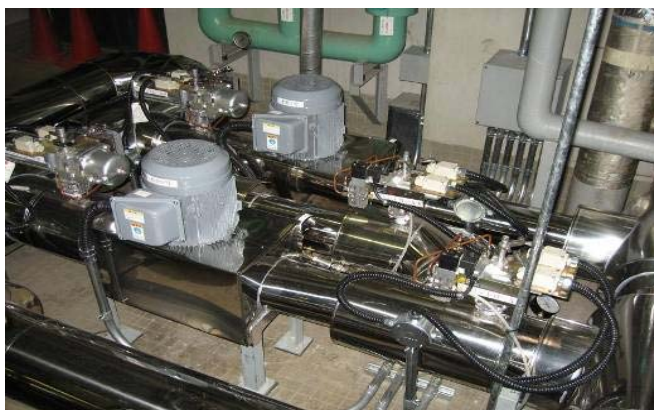
— ビルに設置されている発電機と水車 —
