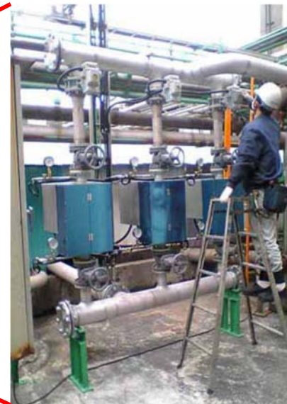
【設置されている発電機と水車】
