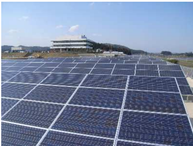
松田新田浄水場（太陽光発電システム）
