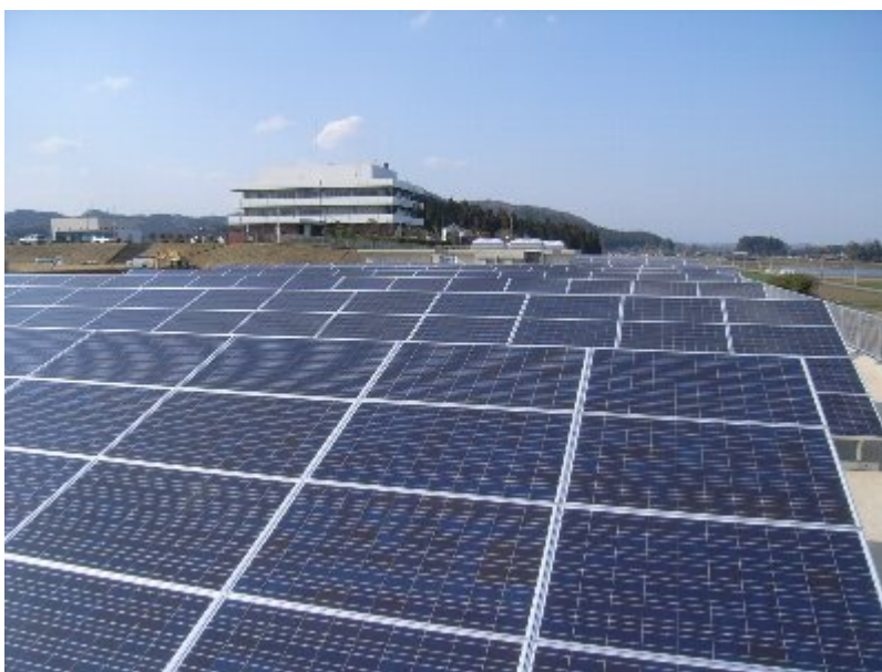
松田新田浄水場（太陽光発電システム）
