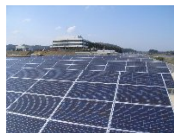
松田新田浄水場（太陽光発電システム：180kW）
