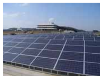
松田新田浄水場
