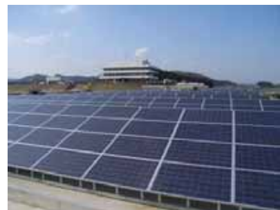
松田新田浄水場
