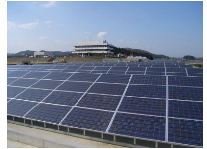
松田新田浄水場
