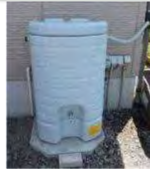
宅地内の雨水貯留タンク
