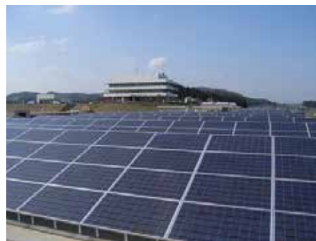
▲太陽光発電（松田新田浄水場）
