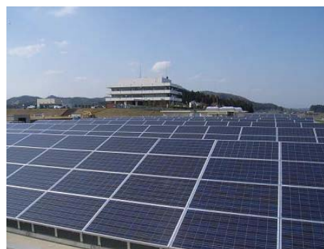
▲ 太陽光発電（松田新田浄水場）
