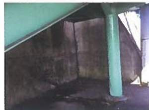
(写真3) 修繕工事前
