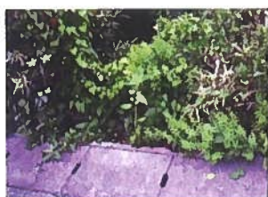
(写真1) 修繕工事前
