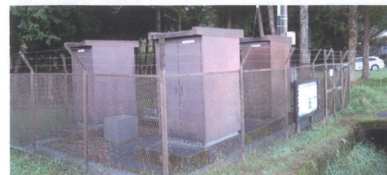
現在の石那田水力発電設備（桑原地区）
