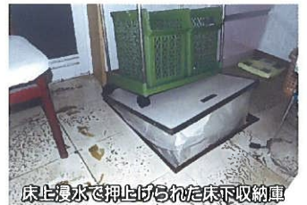
床上浸水で押しつぶされた床下収納庫
