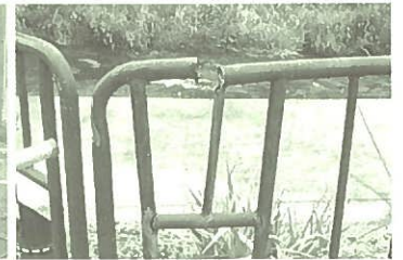
河川の保護柵が破損しています
