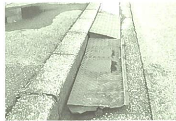
破損している歩道上がり鉄板
