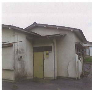
放置された空き家
