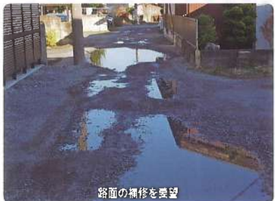
路面の補修を要望
