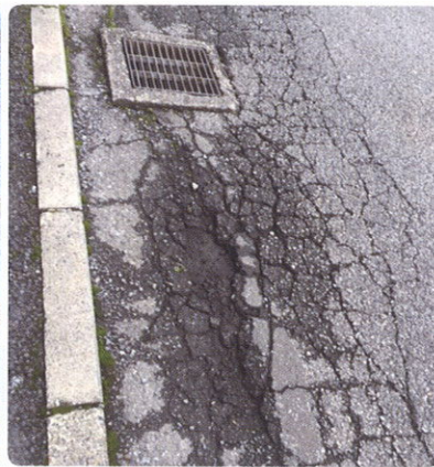
路面のひび割れ・陥没
