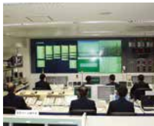
▲更新が予定される消防緊急通信指令システム
