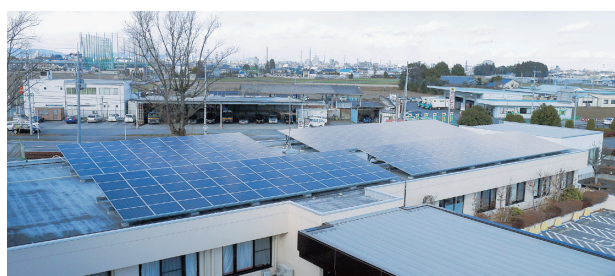
▲サンアビリティーズに設置された太陽光発電設備
