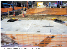
▲耐震性貯水槽
