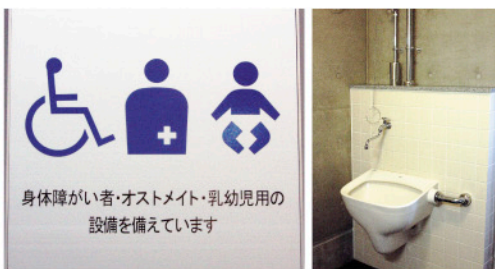
▲オリオン市民広場のトイレに設置されているオストメイトトイレと案内表示
