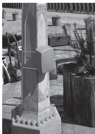
写真1 釜川ふれあい広場に設置した自動計測器
