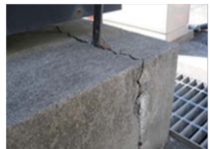
看板基礎のひび割れ
