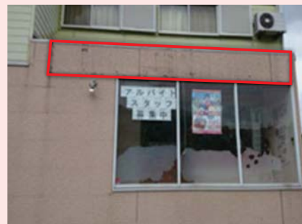
落下した後の壁面
