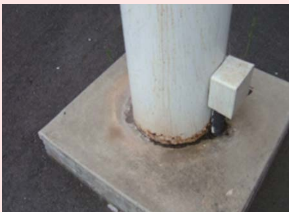
ポールの根元にサビが発生
