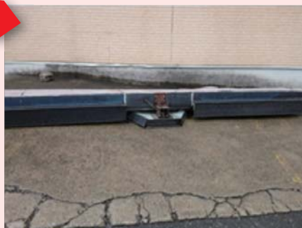
落下した欄間看板
