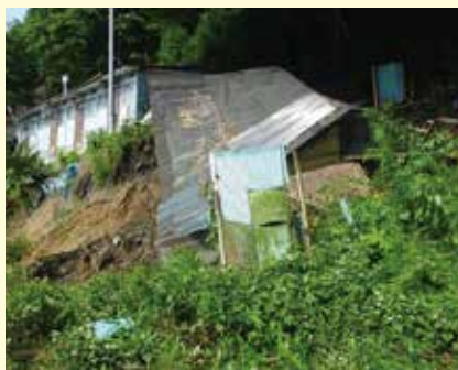
▲平成26年6月に市内で発生した土砂崩れ
