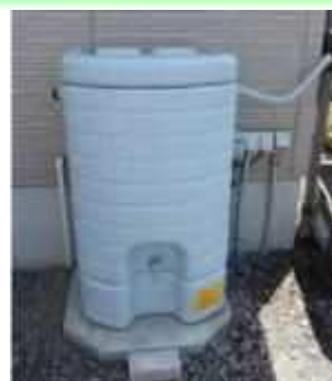
宅地内の雨水貯留タンク
