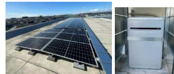
太陽光発電設備・蓄電池
