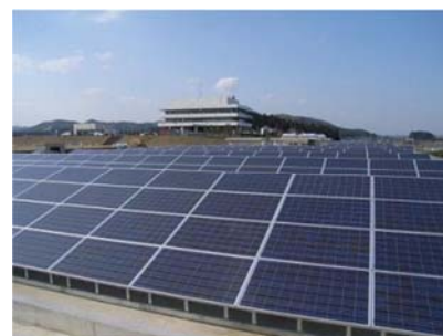
松田新田浄水場
