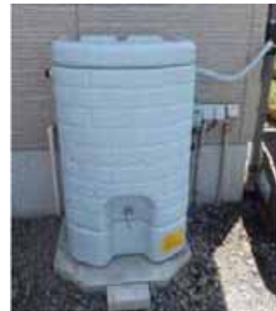
宅地内の雨水貯留タンク
