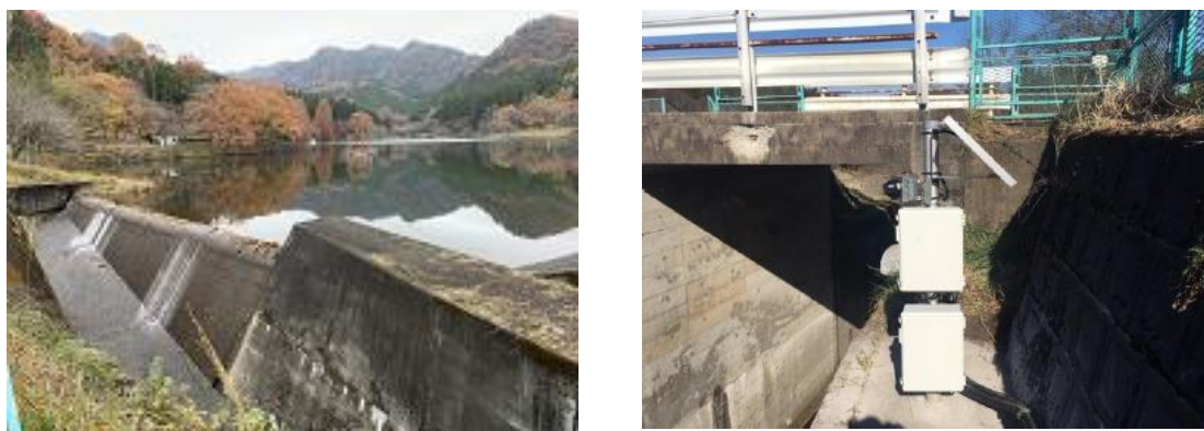
図 3.15 赤川ダム余水吐・堤体状況を監視するために設置したカメラ
