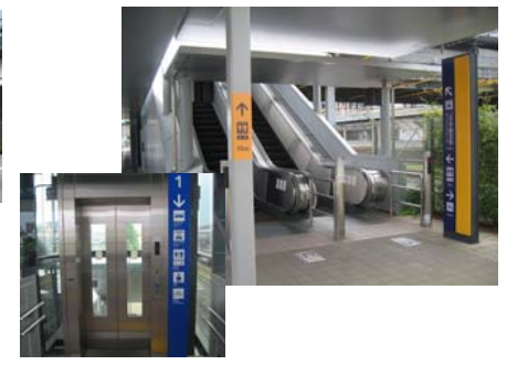
歩行者支援施設 ⑬ （エレベーター・エスカレーター）
