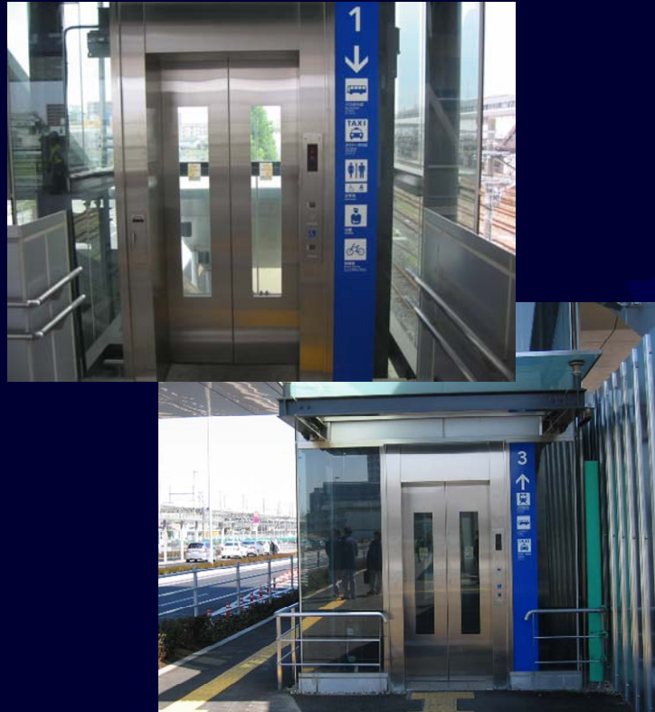
エレベーター
