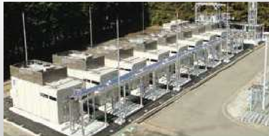
消化ガス発電施設
