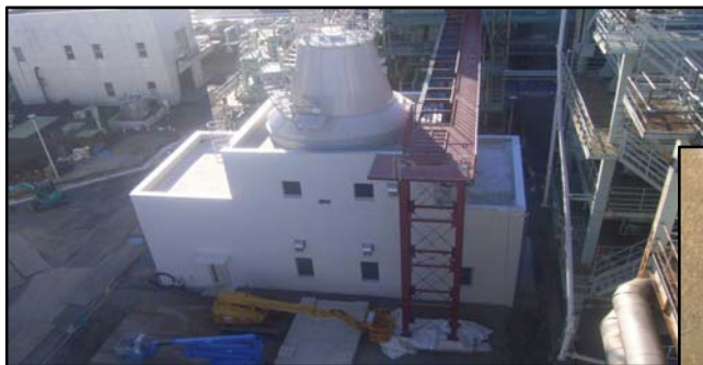
川田水再生センター
