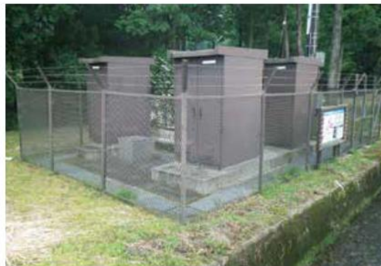
小水力発電（第3減圧所）
