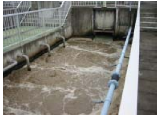
反応タンク（エアレーションタンク）
