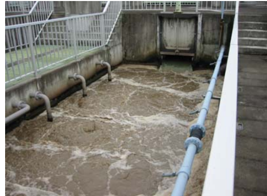
反応タンク (エアレーションタンク)
