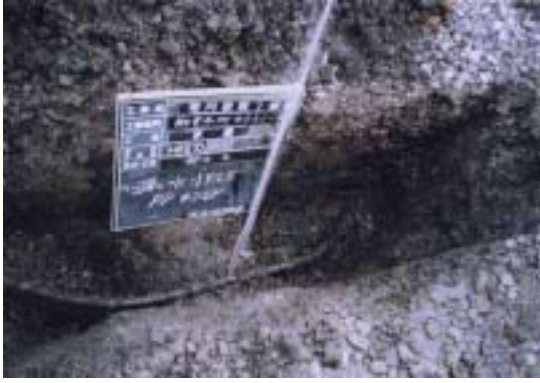
(給水管の漏水状況)
