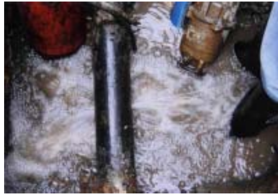
(配水管の漏水状況)
