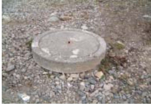
(コンクリート汚水枡の目地ズレからの浸入)
