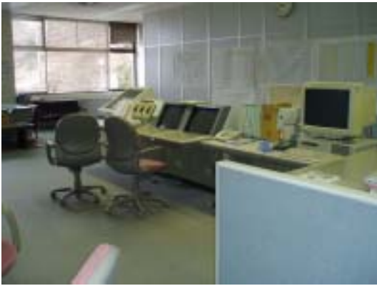
（配水コントロール室）
