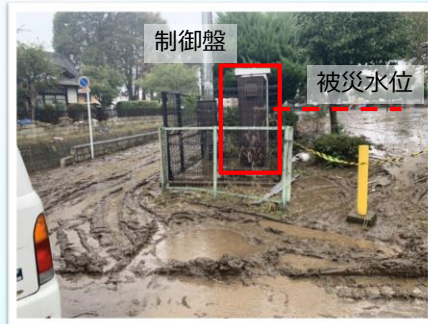
千波合流改善ポンプ場 (田川の河川水により冠水)
