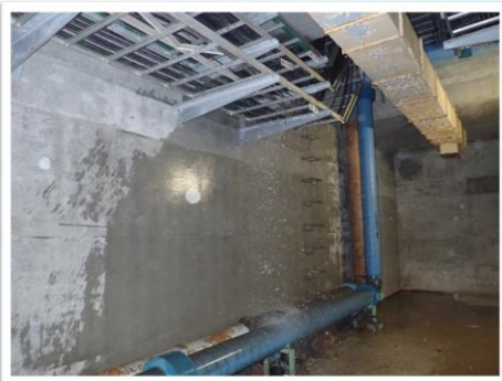
地下への浸水①
