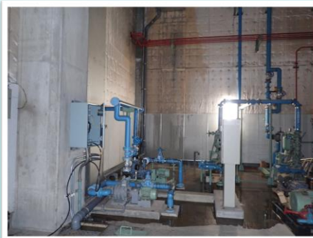
地下への浸水②
