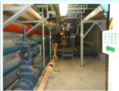
被災後の地下管廊
