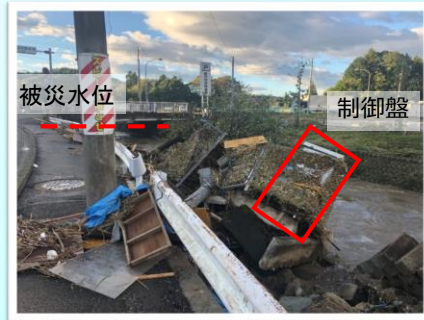
大谷観音ポンプ場 (姿川の河川水により冠水)
