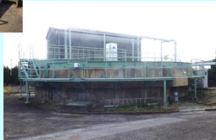
汚泥処理施設
