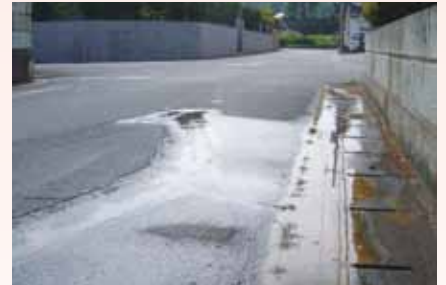
〈水道管から道路上に漏水している様子〉
