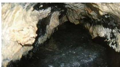
油が付着した下水道管の内部
