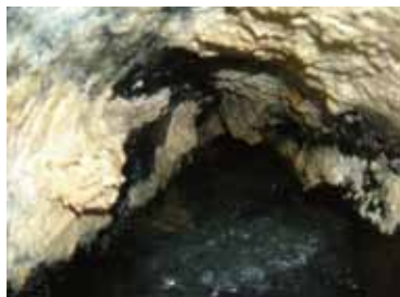
油が付着した下水道管の内部
