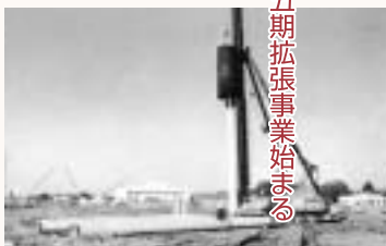
▲第五期拡張事業（板戸配水場建設現場）昭和59年10月、人口40万人を突破し、水需要がますます増加することが予想されたため、新水源を湯西川ダムおよび栃木県からの受水に求めました。
