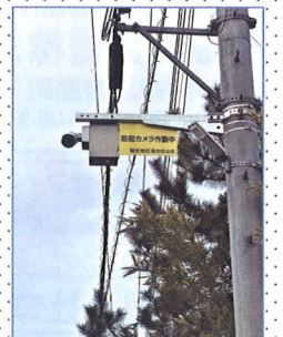
設置されたカメラ
