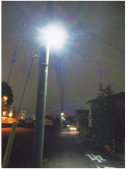
▲LED化された防犯灯
