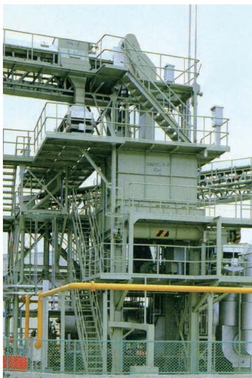
乾燥炉定量フィーダ (昭和56年)
