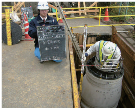
河内特環地区でのマンホール設置工事(平成22年:中岡本町)
