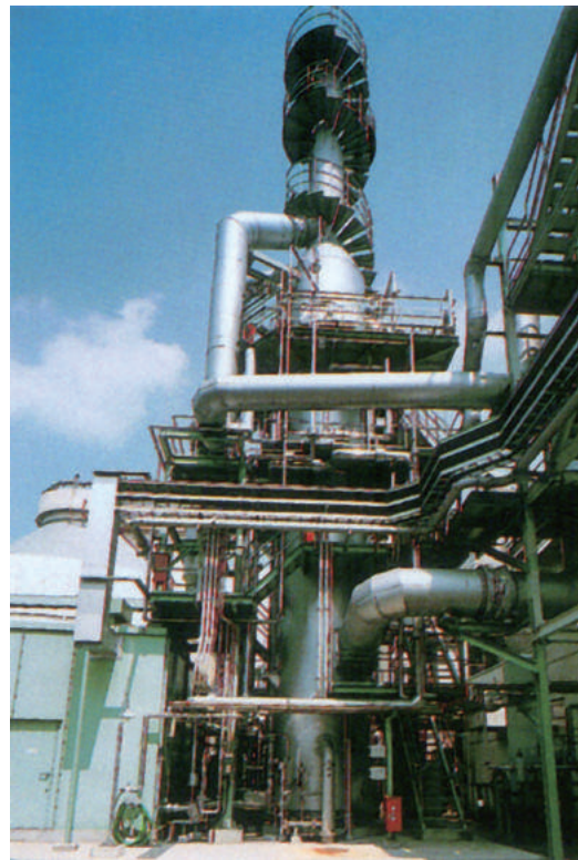
2号炉排煙処理塔(平成8年)
