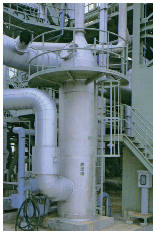
脱湿塔 (昭和56年)
